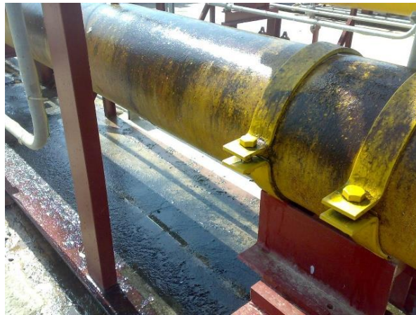
Figure 1 : Gazoduc non enterré subissant une chute de température
